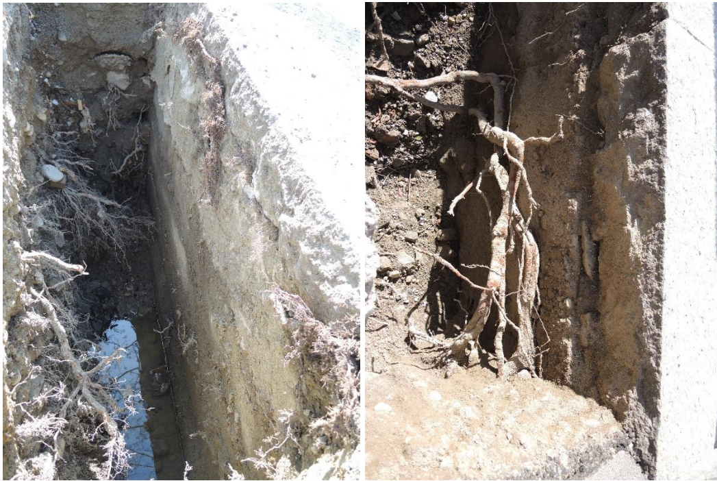
Abbildung 2: Wurzelvorkommen in den Sondierschächten entlang der Hafenummauer
