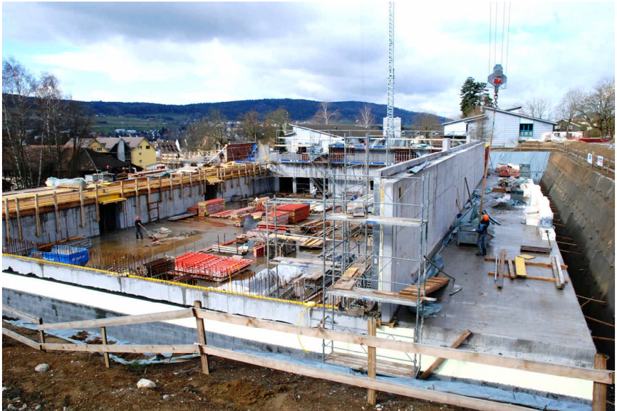
Der Bau der Dreifachhalle Hopfengarten schreitet zügig voran. Die neue Halle wird im Frühjahr 2014 in Betrieb genommen.
